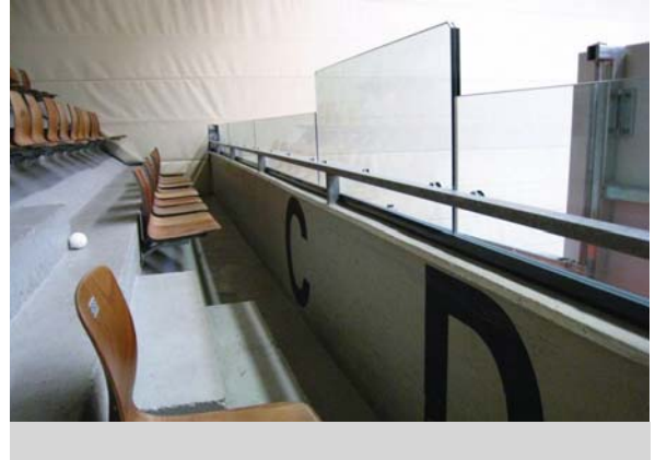
Illustration 35 Protection contre les chutes en verre de sécurité feuilleté rehaussée au niveau des escaliers
